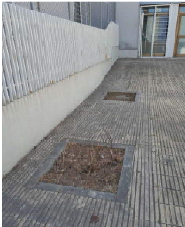
Varios alcorques con ausencia de planta
