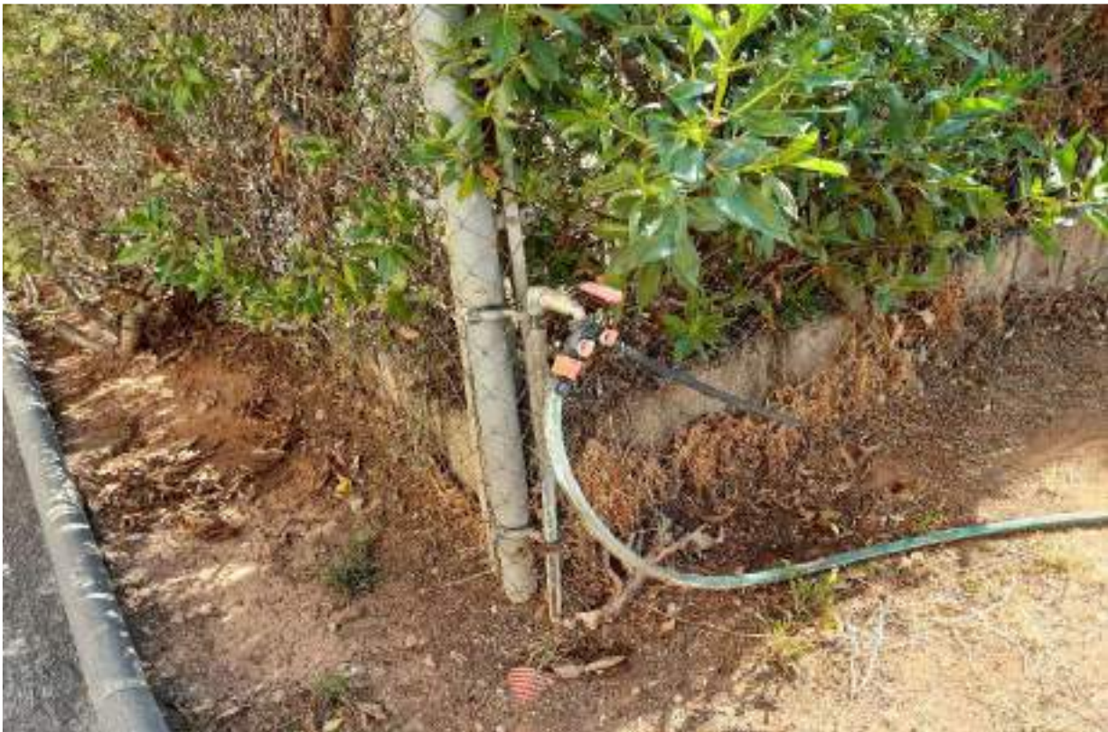
Ausencia de instalaci n de riego
